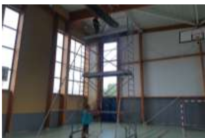
■ Entretien de l'éclairage et du matériel des salles (Services Techniques)
